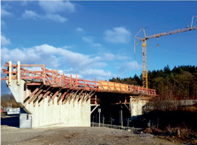
Winterpause in Mühlthal; im Frühjahr werden die Arbeiten an der Bahnbrücke wieder aufgenommen.
