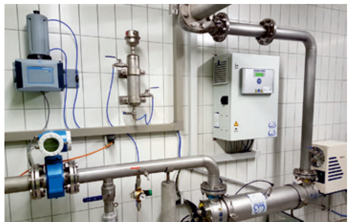
Eine der beiden neuen UV-Anlagen
